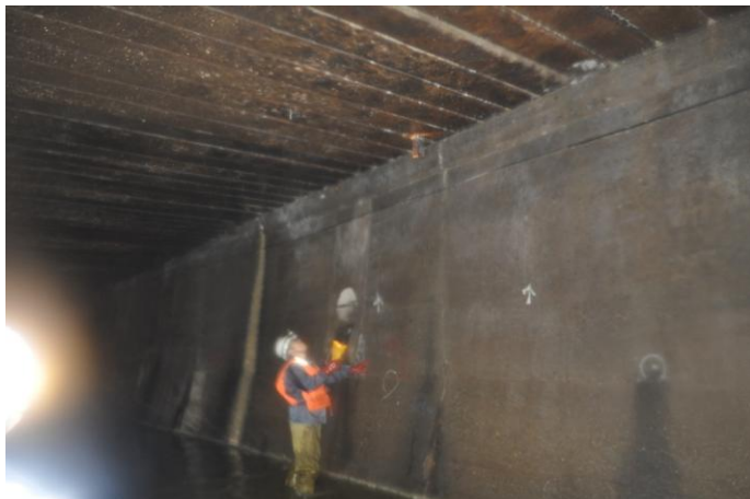
壁は川の護岸そのもの。天井は蓋をしたことがよくわかる
