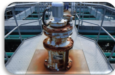
設備の老朽化例
